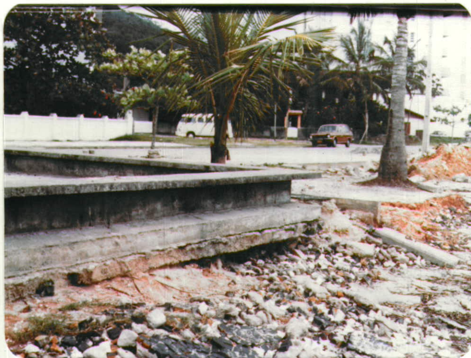
FOTO 10 - Muro descalçado e calçamento parcialmente destruído.
