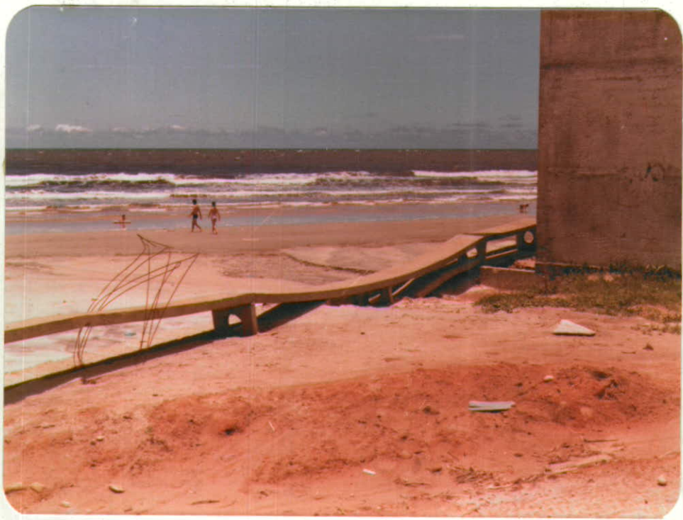
FOTO 21 -- Banco afundado por falta de sustentação.
