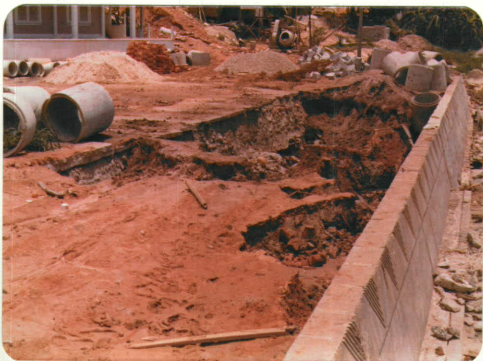
FOTO 22 - Fugas de material do aterro.
