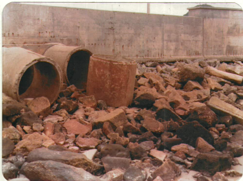
FOTO 3 - Muro de arrimo descalçado e tubulação destruída com enrocamento precário e inadequado.
