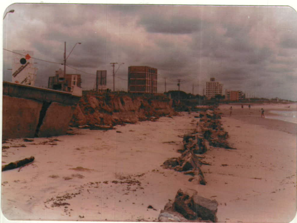
FOTO 7 - Antigo muro de contenção totalmente destruído.
