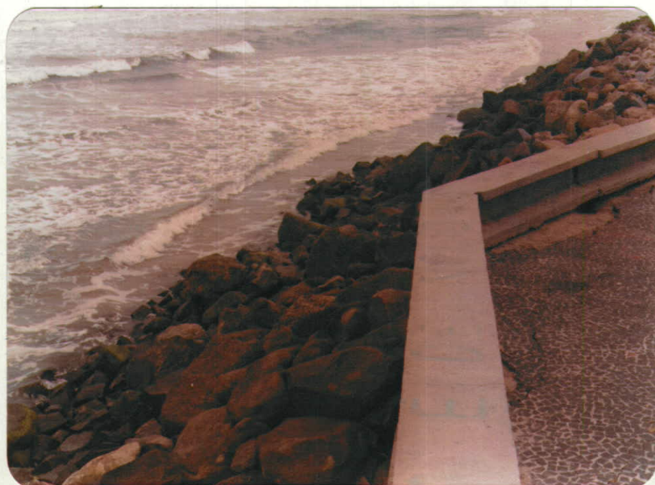
FOTO 9 - Enrocamento inadequado, construído há alguns anos. Nota-se como o seu aspecto melhora com o ataque das ondas e dos organismos.
