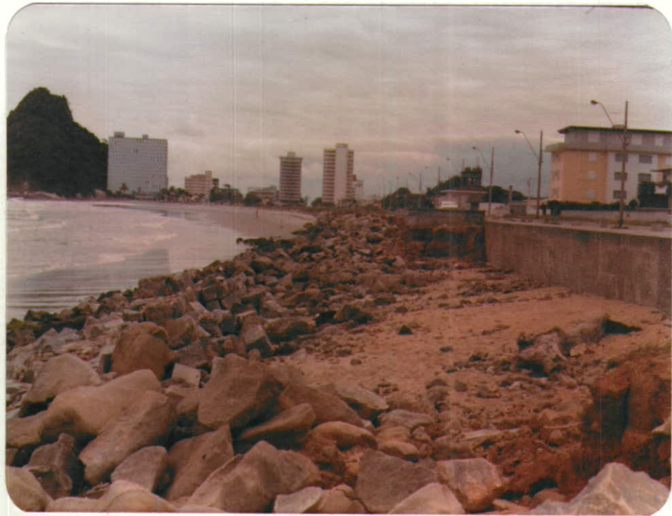
FOTO 2 - Enrocamento inadequado de escasso volume e de pequenas pedras.
