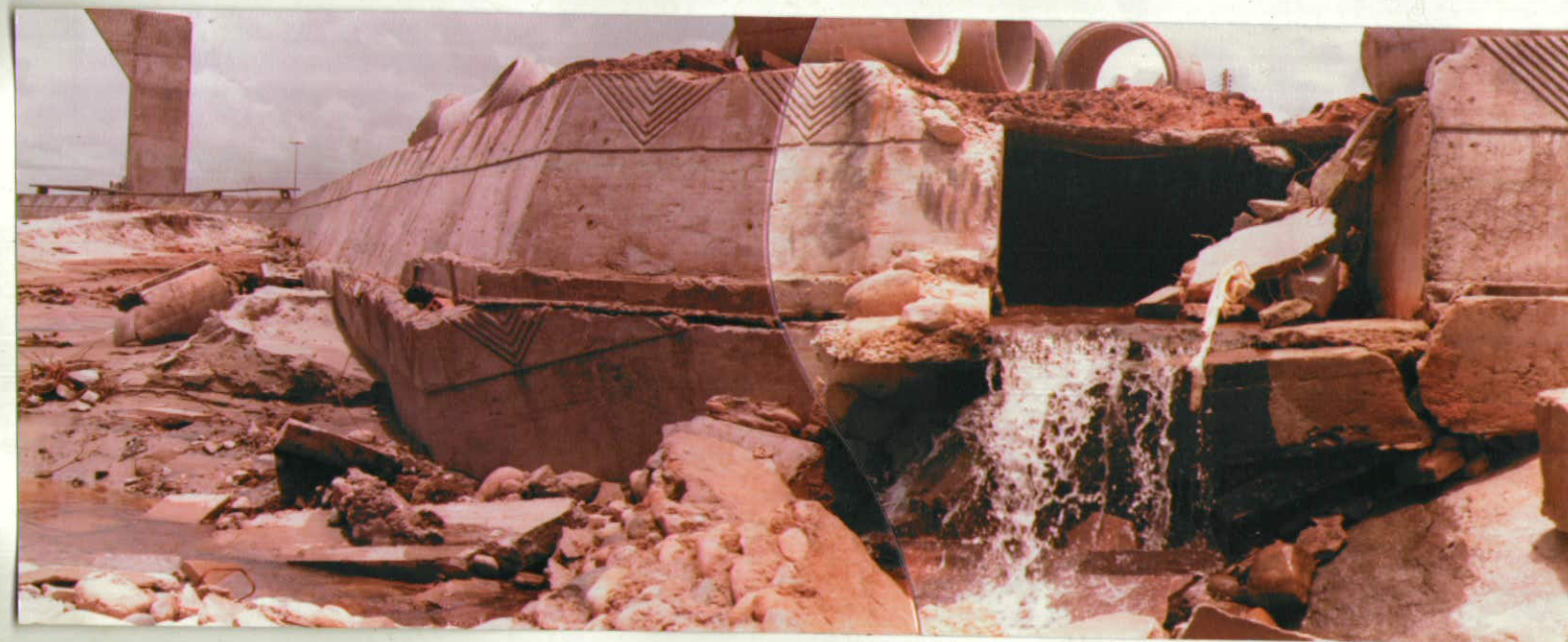
FOTO 17 - Término do sistema de drenagem parcialmente destruído.
